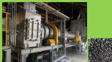
籾殻を用いたバイオ炭製造施設
