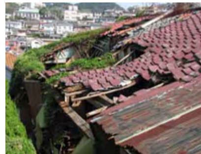
危険空き家の例
