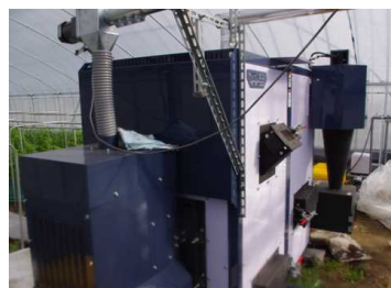
バイオマスボイラー
